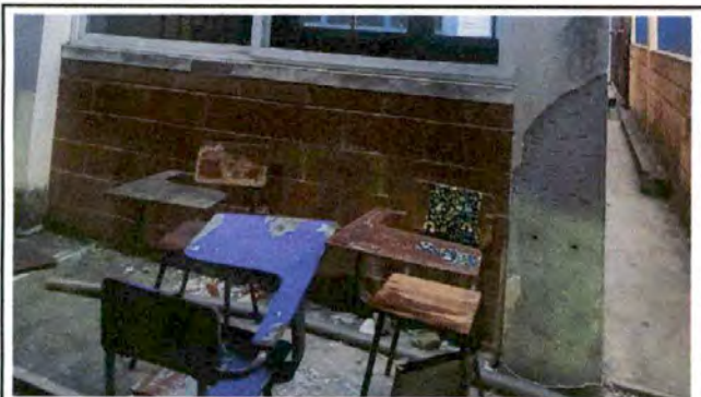
Foto 3: Repello en mal estado
