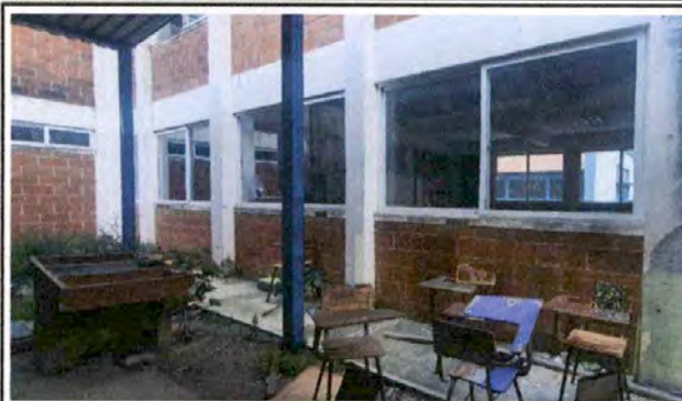
Foto 2: Muros con falta de mantenimiento
