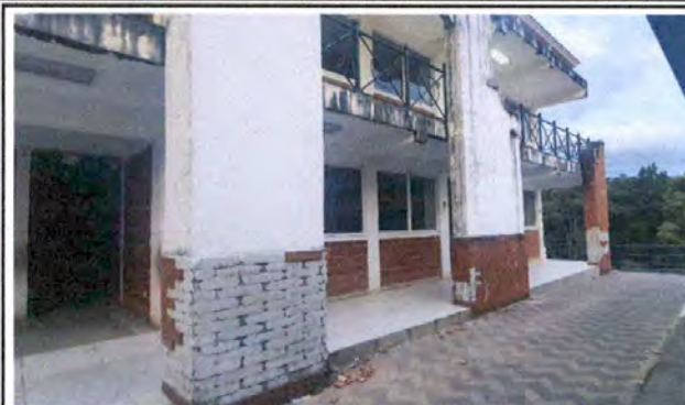
Foto 8: Areas con fachaleta en mal estado
