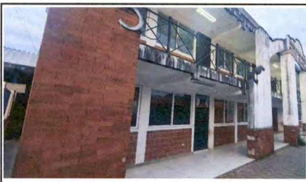
Foto 10: Areas con fachaleta en mal estado
