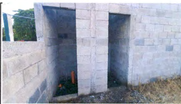
Foto 12: Servicios sanitario inconclusos
